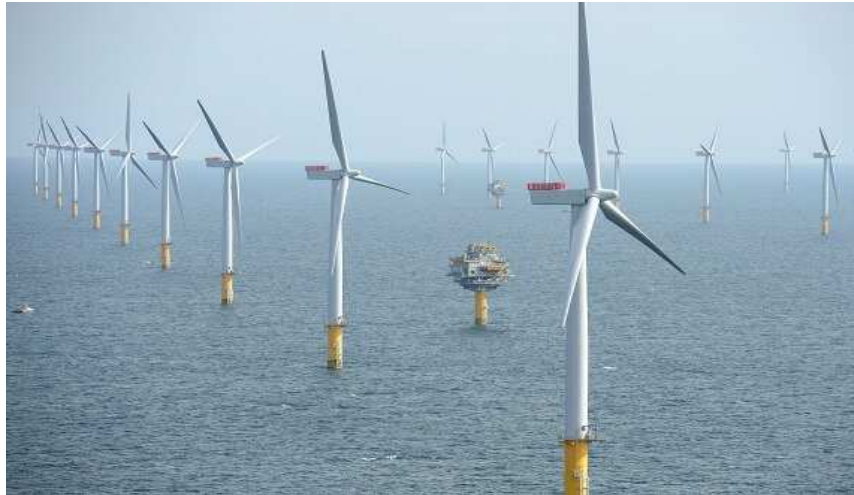
Figure (I-25) : La plus grande éolienne offshore au Royaume-Uni
