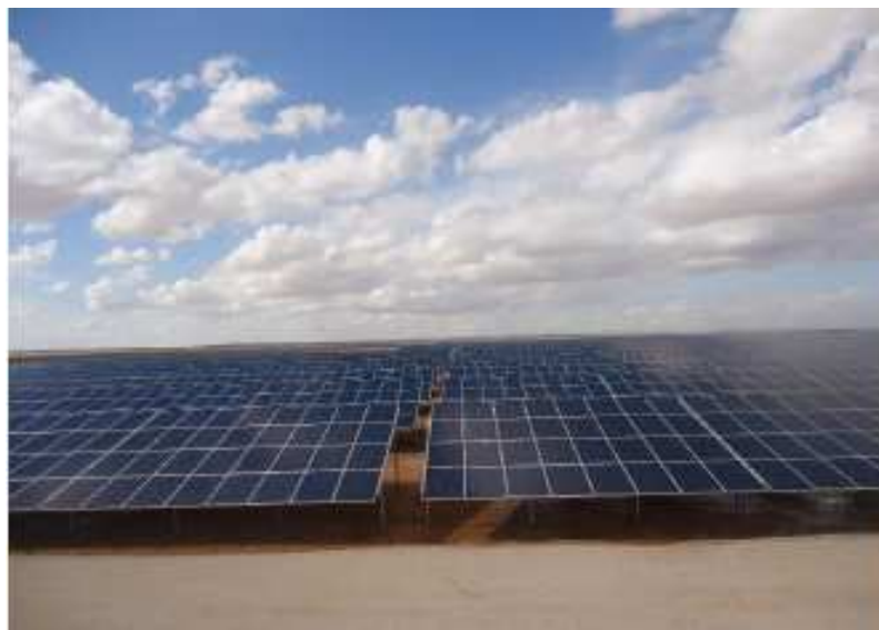
Figure (II-14) : Centrale solaire photovoltaïque de Saida-Ain Skhouna (30 MWc) 2016
