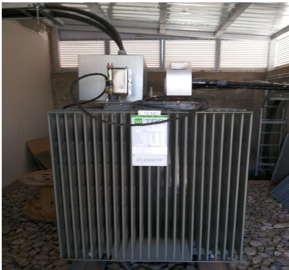
Figure (A-2) : Transformateur Elévateur de Kiosque
