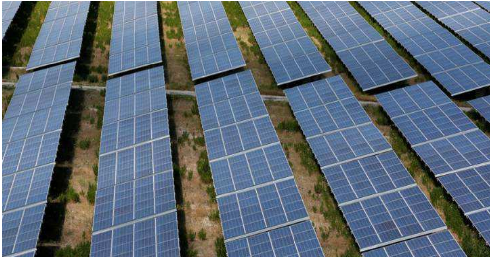
Figure (I-12) : Le plus grand parc photovoltaïque d'Europe qui s'étendra sur 1.981 hectares verra le jour en 2022-2023 dans le Lot-et-Garonne et sera financé à 100% par cinq opérateurs du secteur des énergies renouvelables
