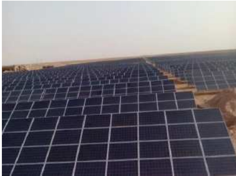
Figure (II-13) : Centrale solaire photovoltaïque de Timimoun (09MWe) 2016
