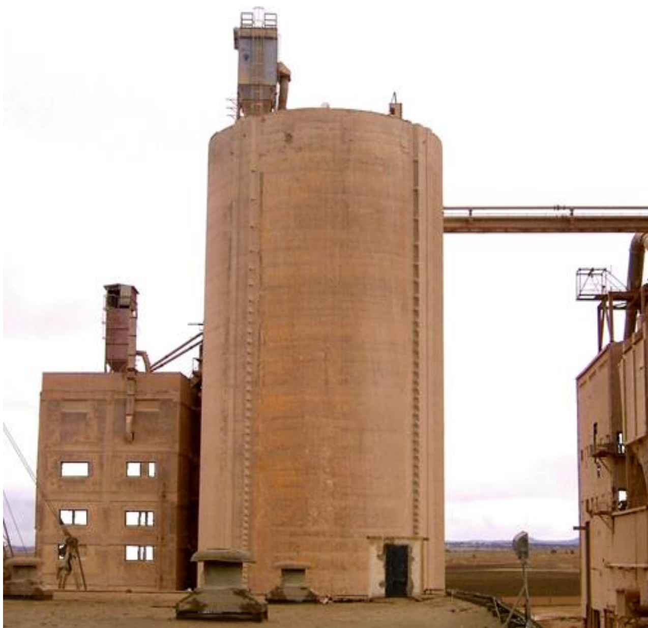
Figure 8 : Silo de stockage et d'homogénéisation.
