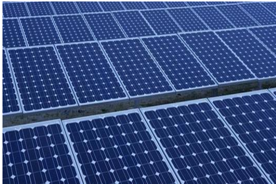
Figure (I.6): Panneaux Solaire Photovoltaïque thermiques.
