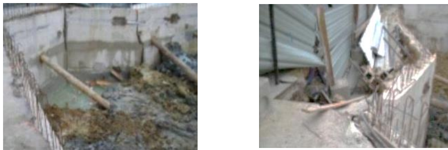
Figure 1.12 Parois moulées : Absence de drainage engendrant une rupture [9]
