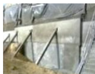
Inclinaison de la partie supérieure d'une paroi moulée
