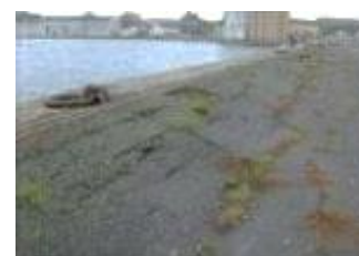
Affaissements et fissures du terre-plein
