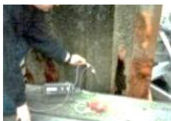
Corrosion des palplanches
