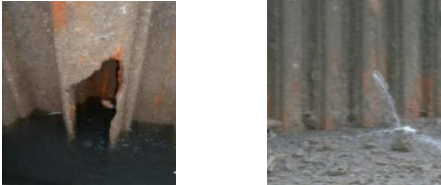
Figure 1.11 Corrosion des palplanches métalliques qui engendre des fuites d'eau [9]
