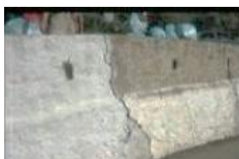
Fissures verticales du parement
