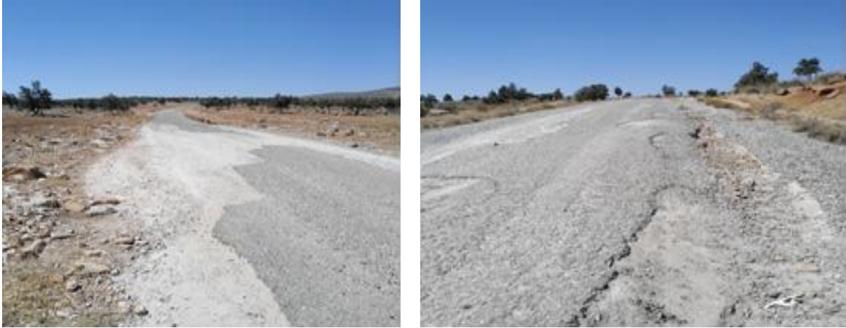
Figure IV-32 : Dégradation de l'accotement
