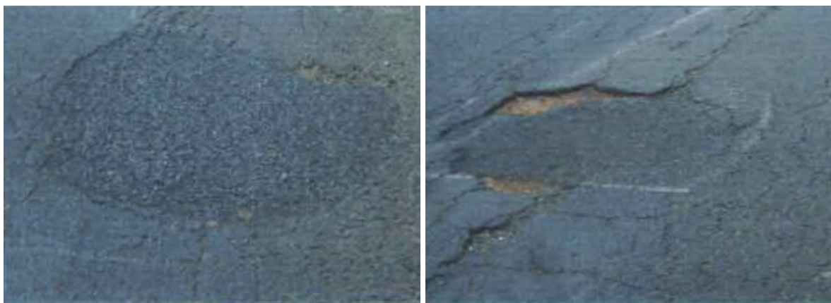
Figure II-12 : Exemple de réparation. [22] Figure II-13 : Réparation dégradée. [22]
