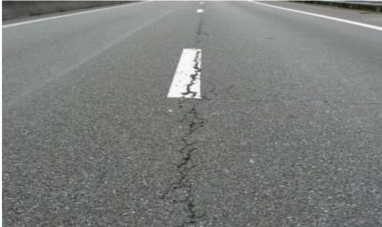
Figure II-5 : les fissures longitudinales.
