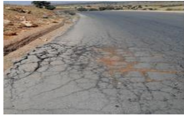
Figure IV-30: Affaissement des chaussées
