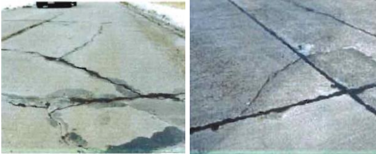
Figure II-16: Réseau de fissures de formes diverses. [23] Figure II-17 : Fissures en coin de dalle.
