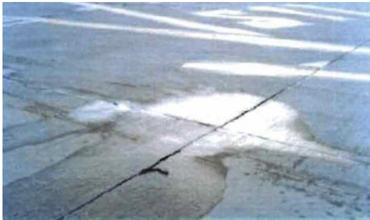
Figure II-20 : Pompage caractérisé par l'humidification de la chaussée aux bords des joints.
