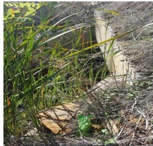
Figure IV-24 : Envasement dalot dalot PK 74+220 (1092+220) côté aval
