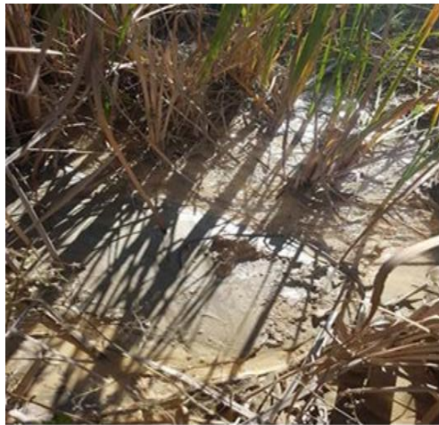
Figure IV-23 : Envasement dalot PK 74+220 (1092+220) côté amont
