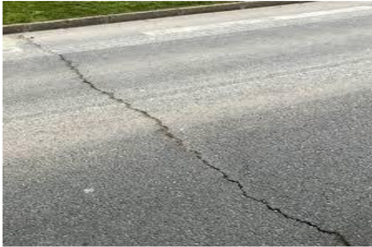
Figure II-4 : les fissures transversales.
