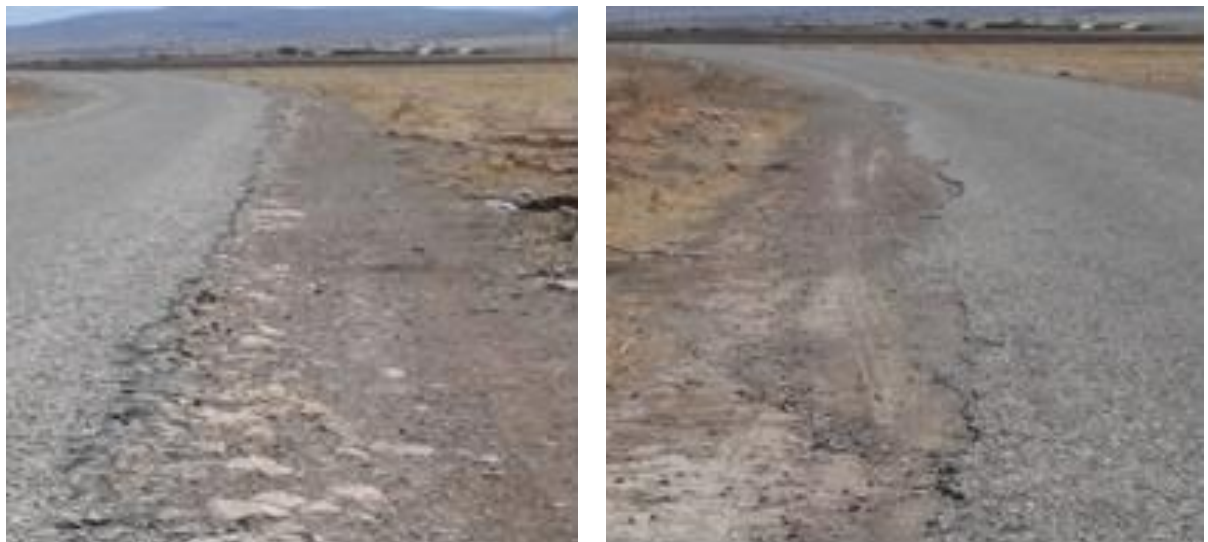
Figure IV-33 : Dégradation de l'accotement
